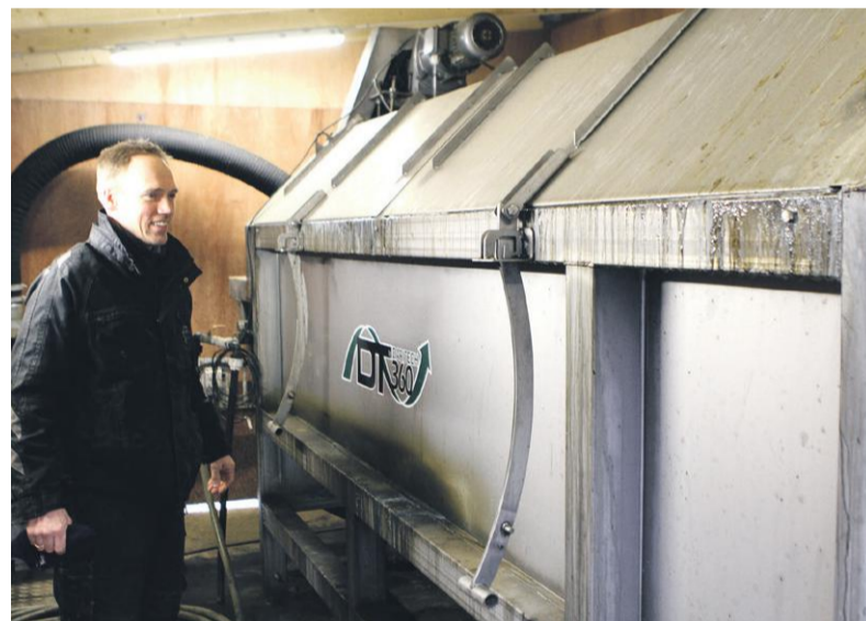
■ En separator, der skiller ajlen fra gyllen er ifølge Jacob Adler Jensen det mest tekniske i separeringsanlægget. Ajlen bliver pumpet tilbage til gyllen for at hjælpe bundfældningen af sandet på vej, mens den tykke gylle bliver hentet til biogas.
